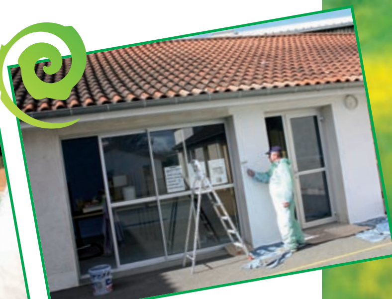
Poursuite du programme de conservation et d'embellissement de nos écoles engagé depuis quelques années par le personnel communal.
